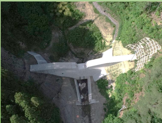
【「安らぎ」と「ゆとり」が持てる県民生活の確保】 七曲の沢筋 砂防えん堤 完成R3.3月
