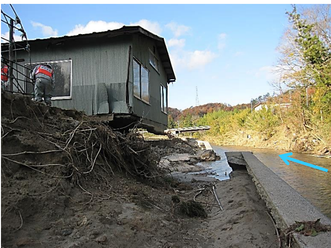
移川（二本松市上長折） 被災状況
