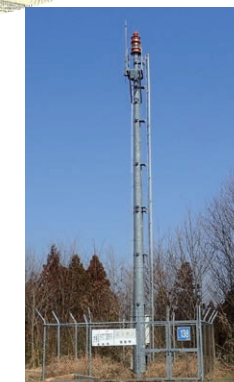
航空障害灯(OBL) 水平表面から突出している地形の位置を示すための灯火です。(場外)
