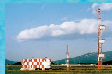
グライドスロープ(GS) 着陸のため進入中の航空機に対し適切な進入角を電波によって示す装置です。
