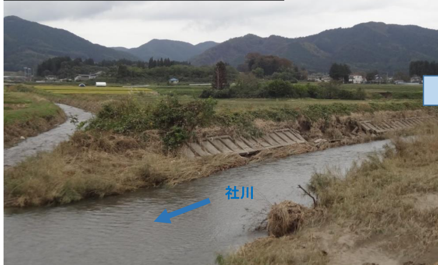
【被災状況（令和元年10月14日撮影）】
