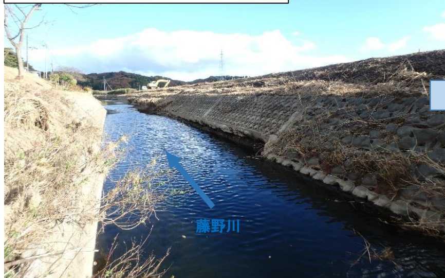
【被災状況（令和元年10月14日撮影）】
