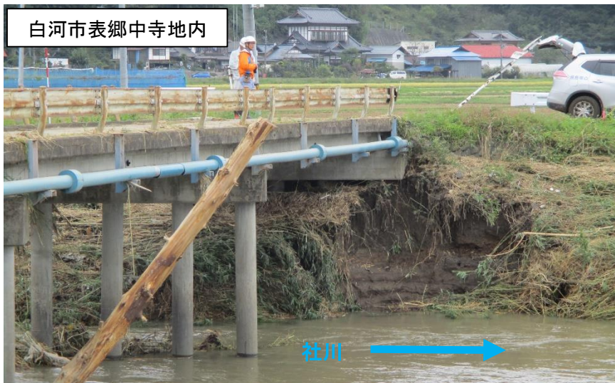
【被災状況（令和元年10月14日撮影）】
