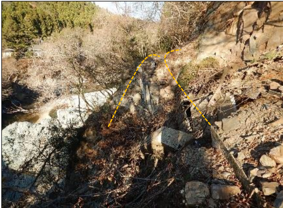
【被災状況 崩落した土砂により用水路が埋没】
