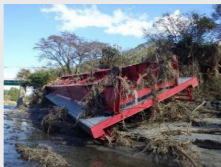
【上部工 第3径間】桁変形
