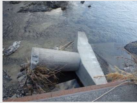
【P1橋脚】柱倒壊
