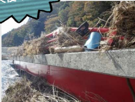
【上部工 第2径間】桁変形
