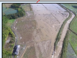
小高川決壊状況
