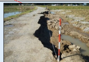
道路崩落状況
