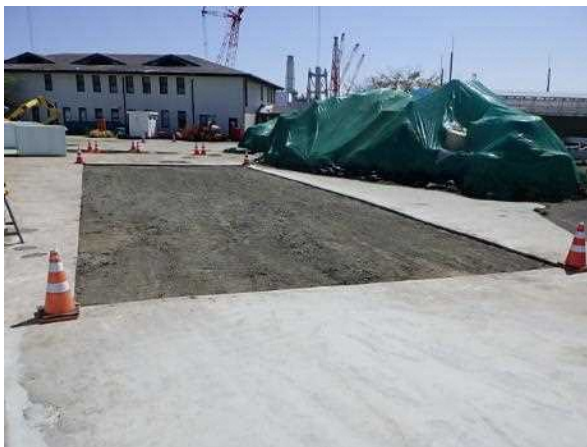
写真3.アスファルトはぎ取り(4月15日) (70 \mu m線量当量率が高い箇所)
