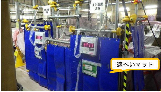
(写真3) 浄化装置設置の状況 (遮へい内に浄化装置が設置されている。)
