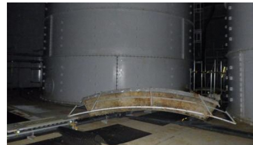
フランジタンク歩廊落下
