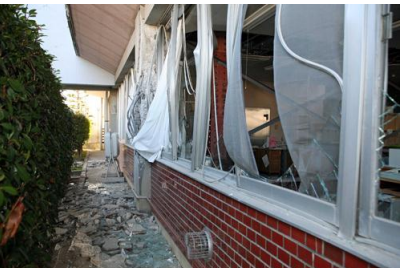
市役所の被災状況（1階、外側）
