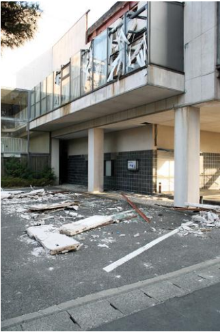
建物の被災状況（東町地内）
