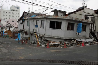
建物の被災状況（加治町地内）
