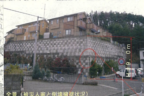
全景（被災人家と倒壊擁壁状況）
