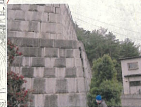
○部 擁壁破壊状況
