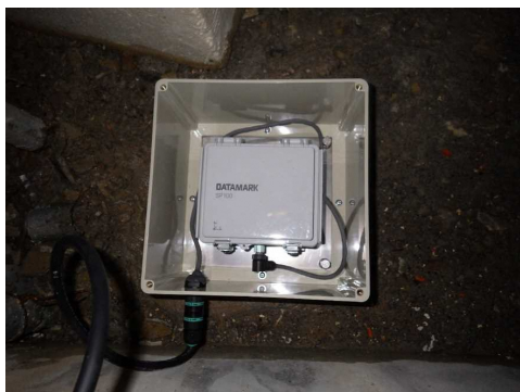
3号機に試験設置した簡易地震計※ (1階レベル)
