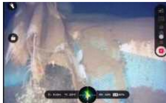
破損している土囊(現在)
