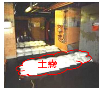
HTIの土嚢状態(設置時)
