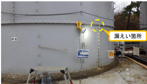
(写真1-2) F1タンクエリア H3タンクの 漏えい箇所の一例
