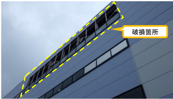
(写真 2 - 1) 大型機器メンテナンス建屋北側壁面 パネルの破損箇所
