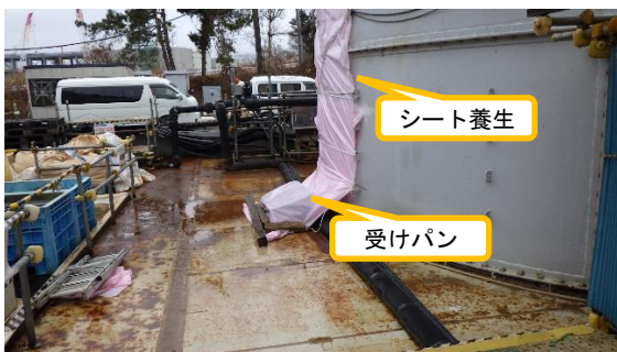
(写真1-4) F1タンクエリア I7タンクの 漏えい箇所下部の状況 (南東側から撮影)
