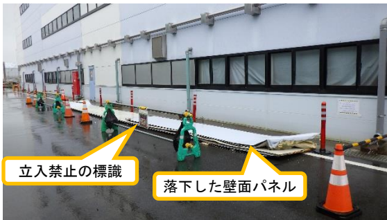
(写真 2 - 2) 落下した壁面パネルの状況
