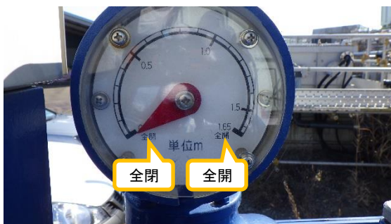
(写真1-2) ゲートの閉止状況 メーターが全閉となっている
