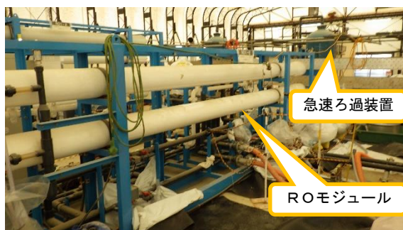
(写真1-2) 淡水化装置 (RO1) の外観
