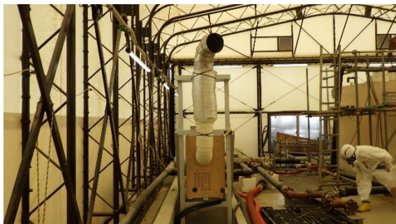
(写真 5) 淡水化装置 (RO1) 建屋内の熱風 発生器 (ヒータ) の稼働状況
