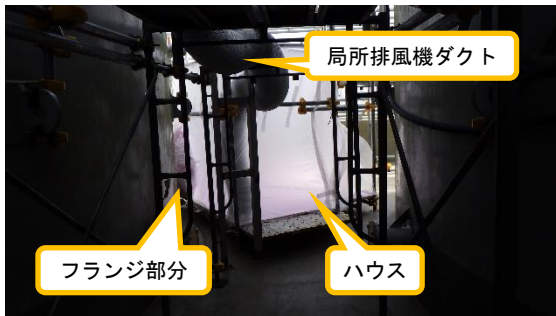
(写真1-1) タンクの側方のフランジ部分周辺の 状況
