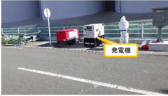
(写真3-1) K2タンクエリア堰外(西側)の状況
