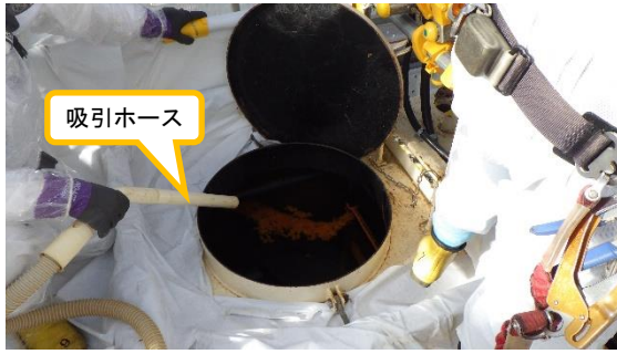
(写真1-3) 中継タンクの上部蓋開放の状況
