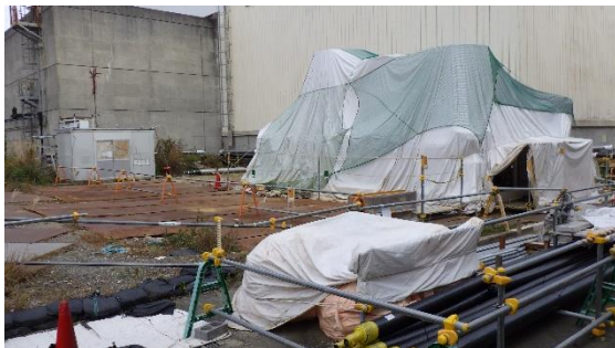
(写真4-1) サブドレン除鉄装置設置箇所外観 (南西側から撮影) 前回(11月12日)撮影
