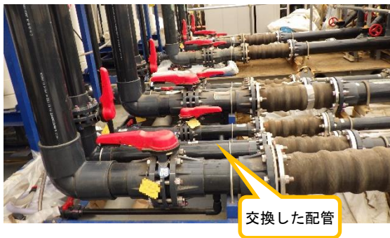
(写真 3) UF 出入口回りの配管の状況 (西側から撮影、写真左がUF側)
