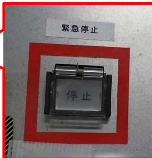
緊急停止ボタン
