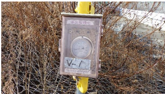
(写真 3) 温度計の設置状況
