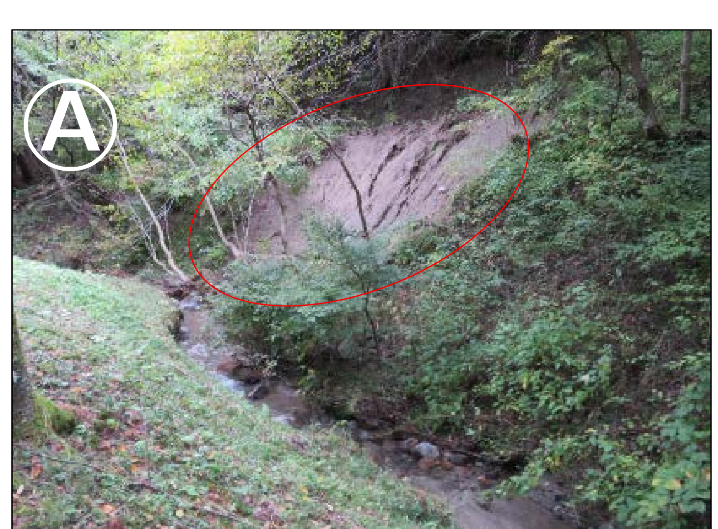
敷地北側の法面崩壊
