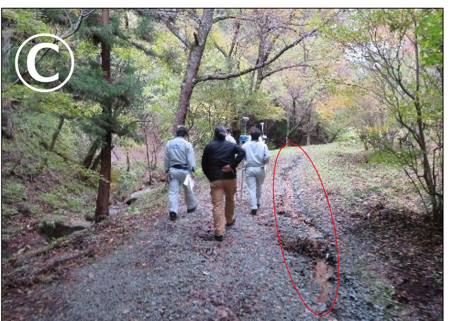
地表面の侵食（細溝の発生）
