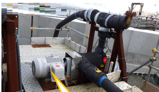
(写真1-2) 純水タンク脇炉注水ポンプユニットの状況② (南側から撮影)
