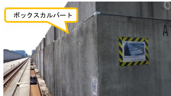
(写真 3 - 2) 同左 (ボックスカルバート周辺に異常は確認されない。)
