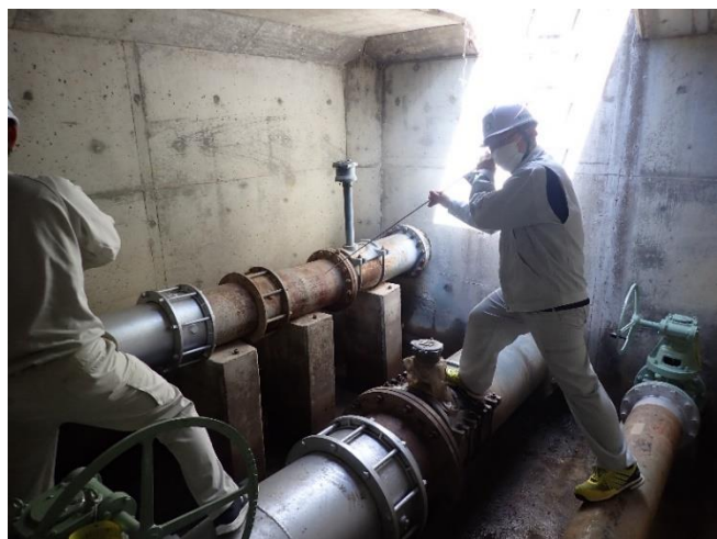
本宮市白沢地区パイプライン劣化状況調査
