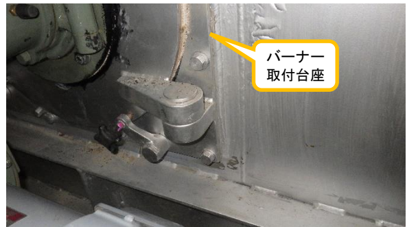
(写真2-2) A系二次燃焼器のバーナー取付台座下部の状況
