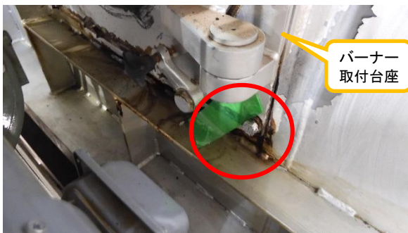
(写真2-1) B系二次燃焼器のバーナー取付台座下部の状況 (赤丸印が蒸気状の気体が出ていた箇所)
