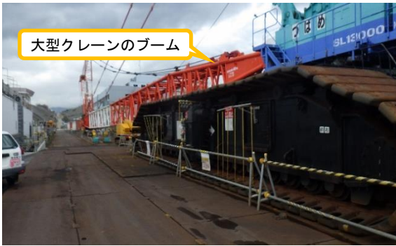
(写真3-1) ブームが伏せられた大型クレーン (1号機原子炉建屋北側)
