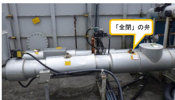
(写真4-3) 移送管の状況 （「全閉」の表示がされていた。）
