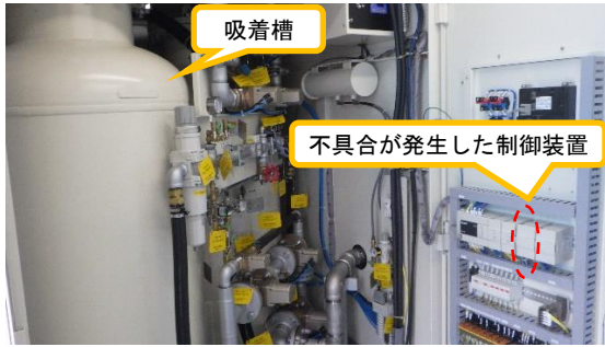
(写真 2 - 2) 窒素ガス分離装置 (B) 内部の状況
