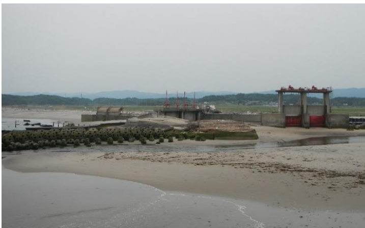
被災直後 堤防やゲートが壊滅
