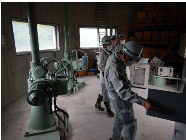
二本松市岳ダム 水門操作機器点検
