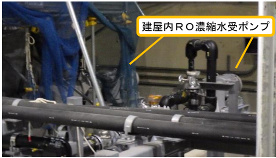
(写真1-3) 建屋内RO濃縮水受ポンプ (写真1-2の赤線部拡大)
