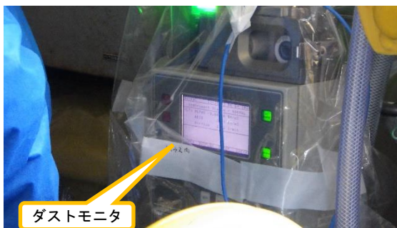
(写真3-1) ダストモニタの設置状況
