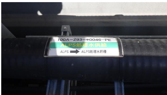
(写真1-4) 配管の表示
