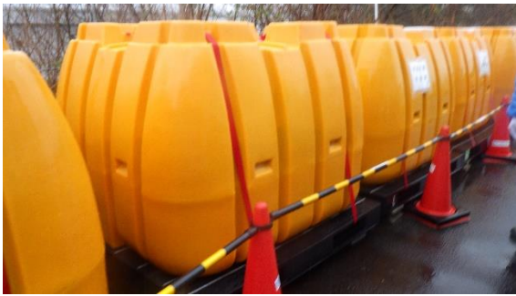
(写真 2 - 3) タンクの固定状況
