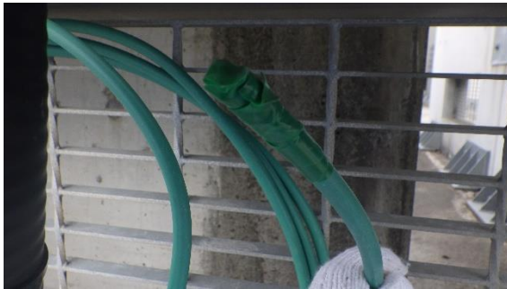
(写真2-2) 接地線の先端部分 接地線は未接続の状態
