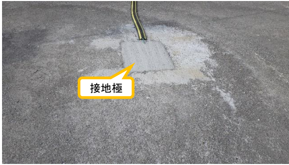
(写真1) 新設した接地極の一例
