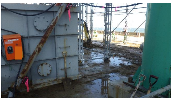
(写真1-3) 流れ込んだ土砂の状況
