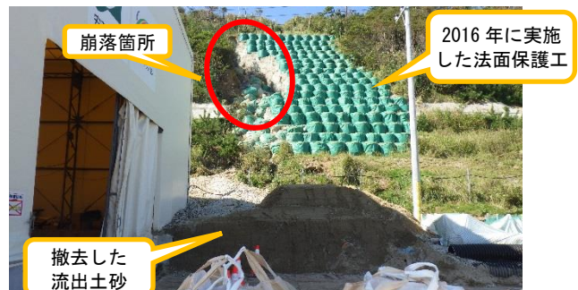
(写真1-2) 崩落箇所の状況② (東側から撮影)
