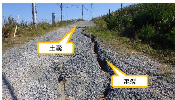
(写真4) 進入道路の亀裂の状況 (進入道路北側を下から撮影)
