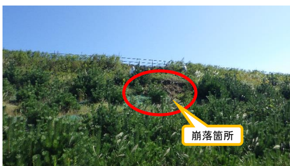
(写真3-1) 崩落箇所の状況① (エリア西側法面を下から撮影)
