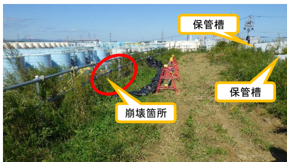
(写真3-2) 崩落箇所の状況② (エリア西側を北側から撮影)
