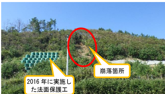
(写真1-1) 崩落箇所の状況① (東側から撮影)
