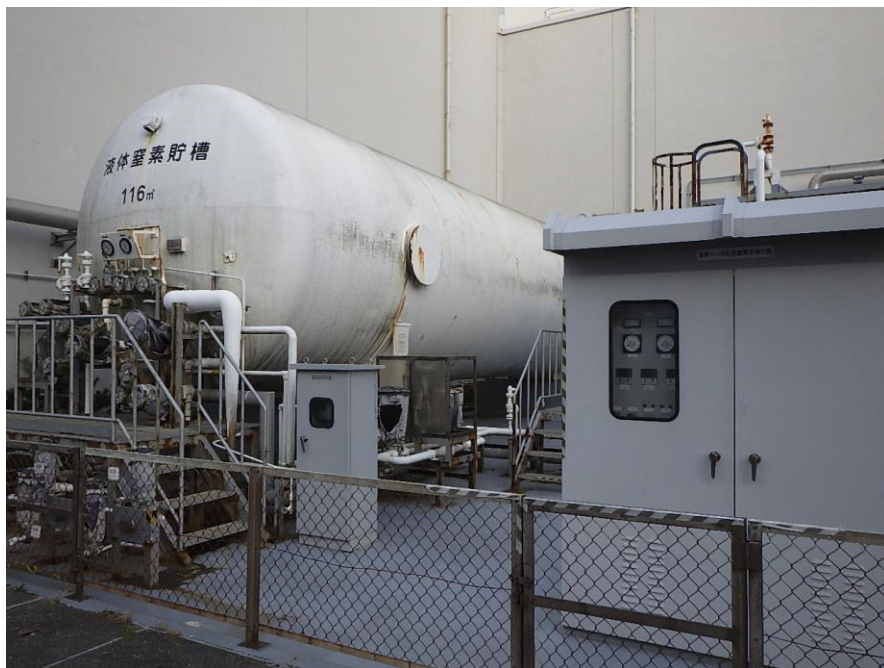
＜格納容器内ガス濃度制御系＞
