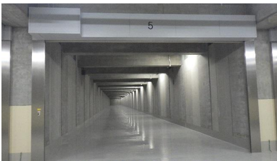
(写真 2 - 3) 貯蔵庫の状況③ (地上 2 階の未搬入貯蔵レーンの 例)
