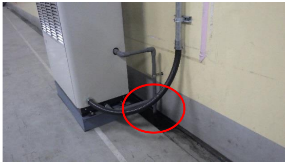
(写真1-2) 凝縮水がエアコンから排水されている (赤丸部分)
