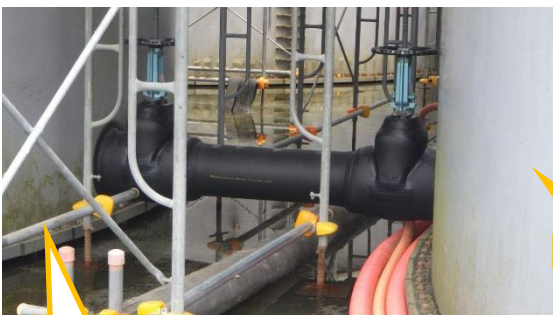
(写真 3) 連結配管の例
