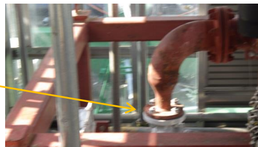
(写真2) 漏えいが確認されたフランジ部
