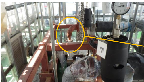
(写真1) 移送ポンプ小屋内の様子
