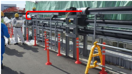
（写真1）赤いラインが今回新たに追設された配管
