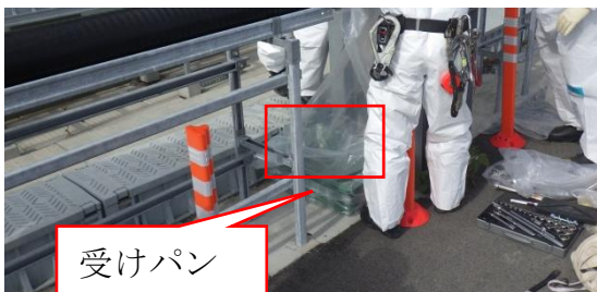
（写真2）赤枠内に抜き取った残水がある
