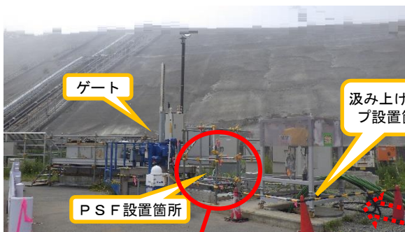
(写真1) K排水路PSFモニタ等設置箇所 (北側から撮影)
