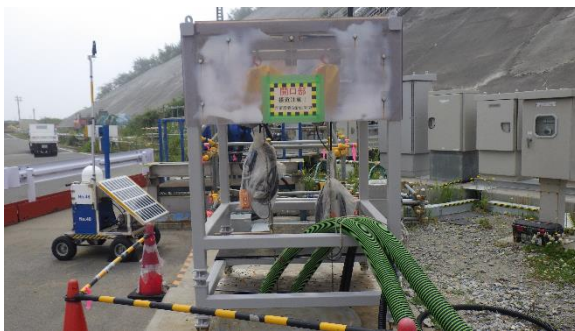
(写真4) K排水路の中に設置された汲み上げポンプと耐圧ホースの状況 (北西側から撮影)
