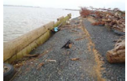
(護岸工被災状況・大洲地区)
