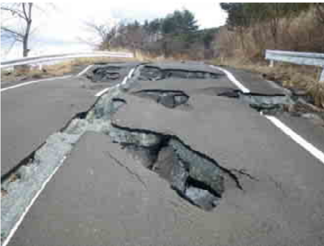
地震による林道の被災状況 川俣町
