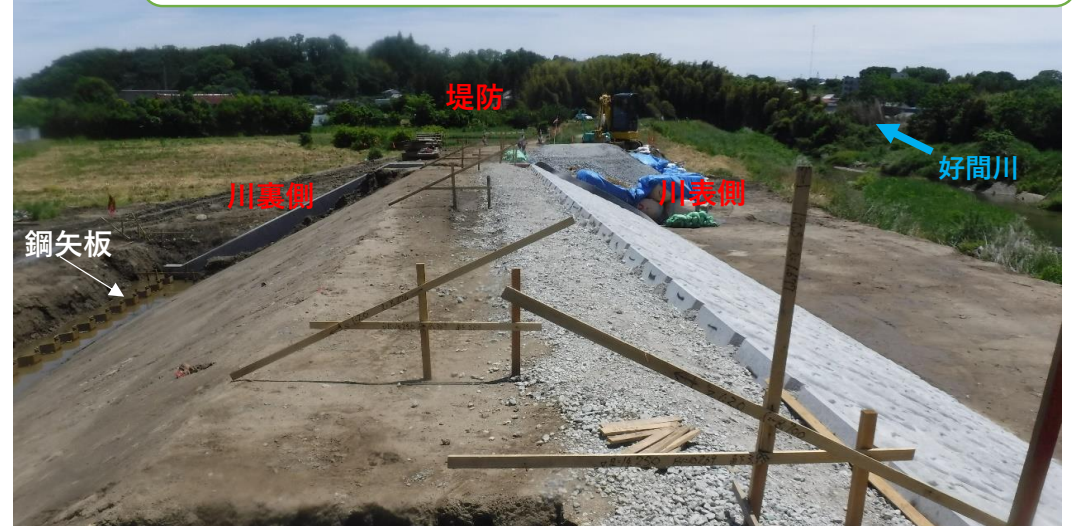
川表側 コンクリート張ブロック完了 川裏側 鋼矢板打設完了
