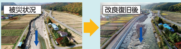
【平成27年 関東・東北豪雨の事例】 桧沢川 (南会津町) 災害復旧助成事業により、護岸の復旧とあわせて河道拡幅などの河川改良を行い、河川の流下能力向上を図りました。
