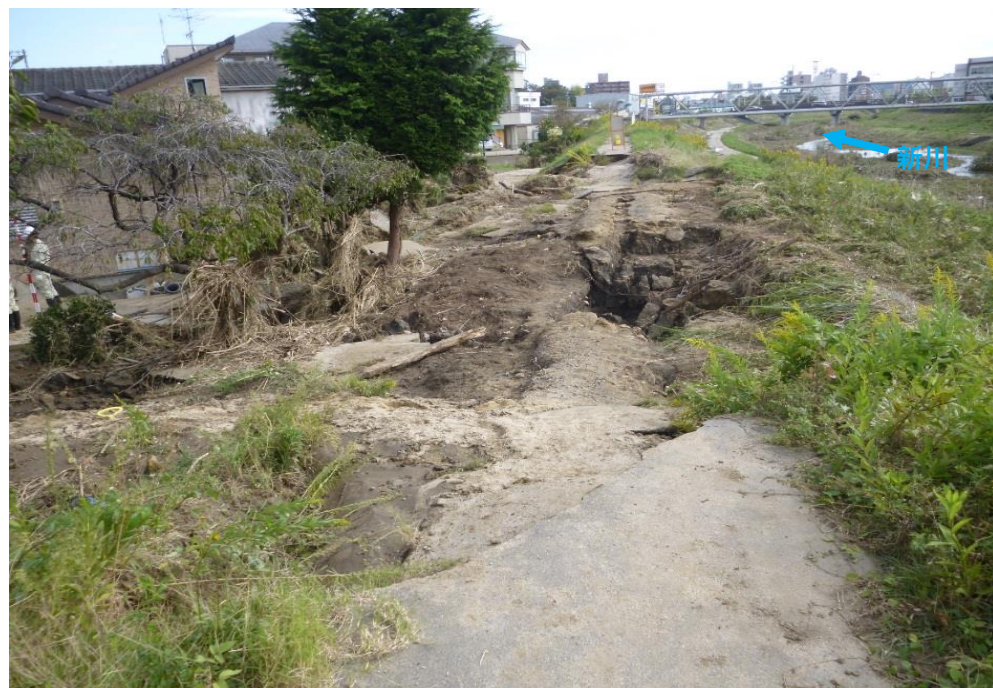
被災状況（令和元年10月14日撮影）
