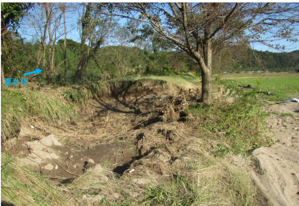
被災状況 (令和元年10月14日撮影)
